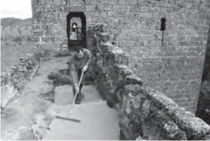
Castillo. Colmatación de escalera de servicio medieval excavada en el migajón del Lienzo 1.
