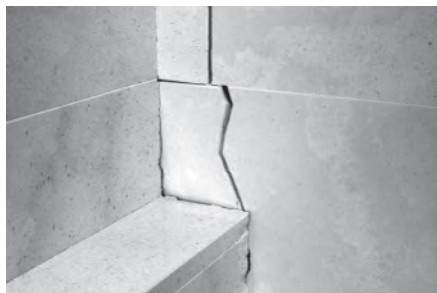
Daños por asiento de la obra producidos en la puesta en valor del horno de cal hispanorromano (Ruta de Arqueología Urbana).
