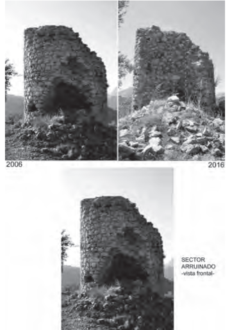
Torre del Espartal. Detalle del sector afectado por el derrumbe.
