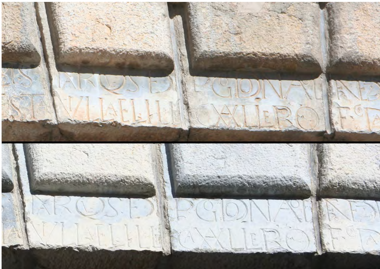
Carnicerías Reales. Evidencia fotográfica (antes y después) de los efectos producidos por una limpieza innecesaria con chorro de arena.
